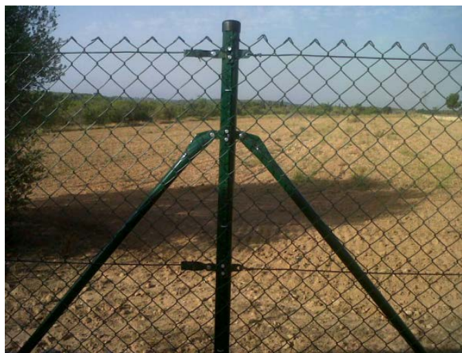
Image 7. Image du poteau principal centre avec les tendeurs et le câble.
